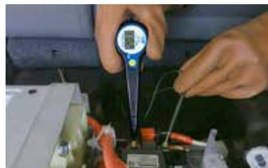
駆動用バッテリーの電圧測定
